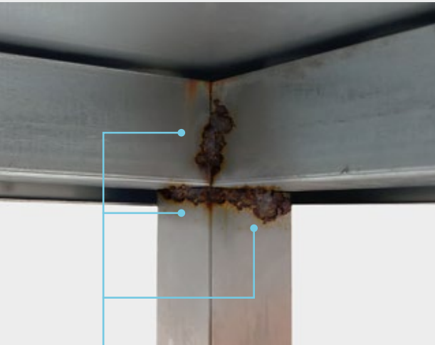
Oxidación por soldadura
